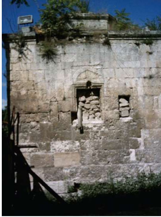
Şekil 8. Edirne Saatli Medrese Güney Cephesi/ kapılarite ile tuzların, asitli yağmur sularının taşa yarattığı yüzeysel erozyon tahribatı (Dal, 2005).
